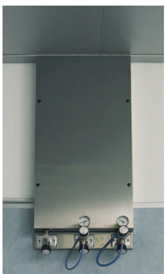
IMPIANTO GAS TECNICI
